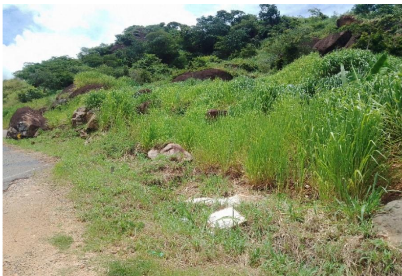
Figura 11 – Área de queda de blocos, próximo a cidade de Guiricema-MG.
