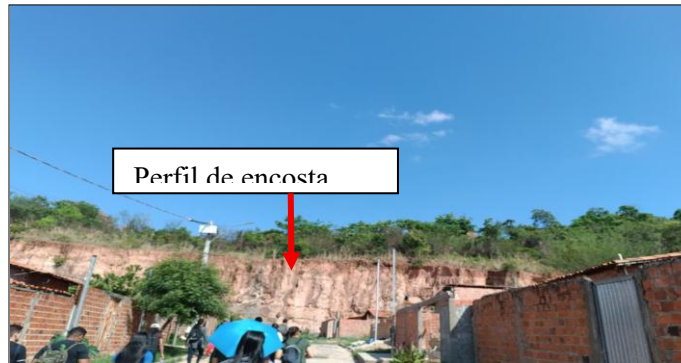
Figura 5 - Área com incidência a deslizamento de terra no médio curso da sub-bacia
