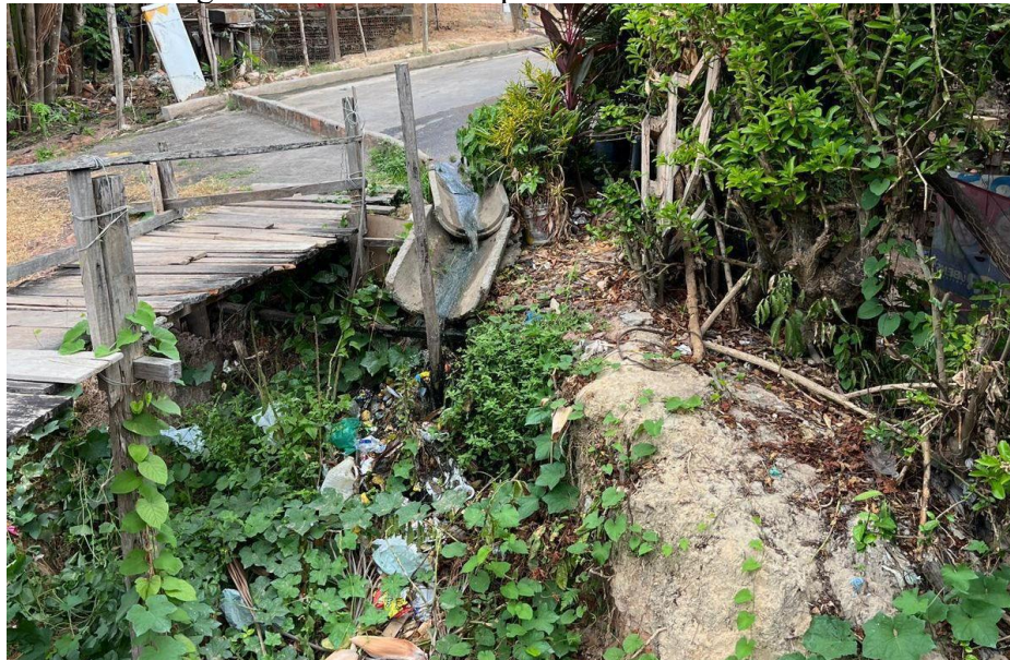
Foto 3 - Esgoto à céu aberto nas proximidades dos setores 2.3 e 2.4.
