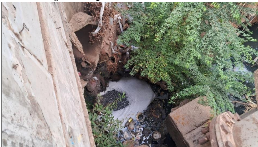
Figura 7 - Esgoto direcionado diretamente ao rio.
