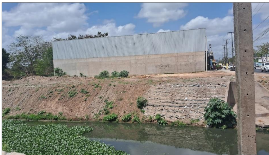
Figura 8 - Margem do setor III com solo exposto.
