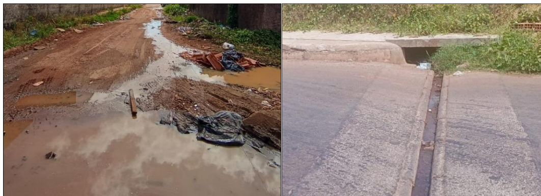
Figura 4 - Rede de águas pluviais com presença de resíduos.
