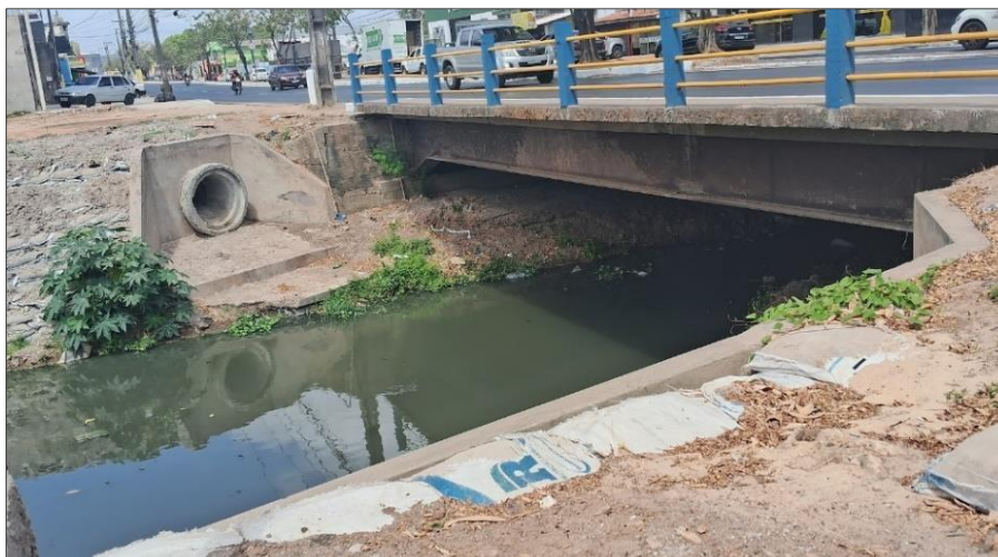
Figura 9 - Lançamento de esgoto in natura no rio.
